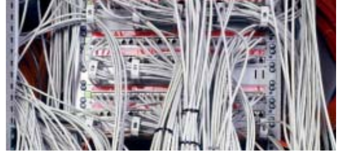
Blick in die Computerzentrale
